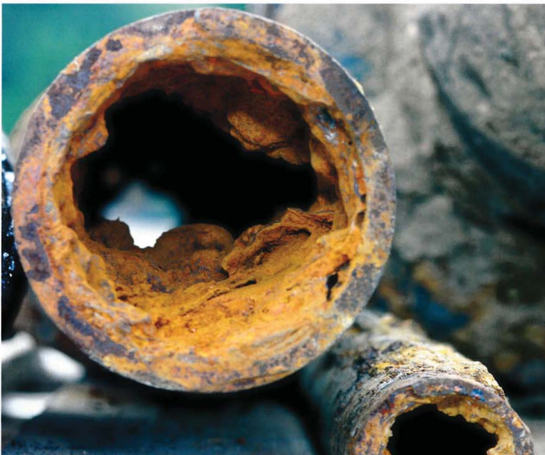
So sehen leider häufig alte Wasserrohre aus. Je länger das Trinkwasser in diesen Rohren steht, desto mehr Schadstoffe nimmt es auf.
